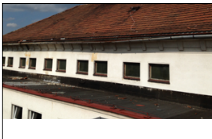
Střecha sokolovna před před rekonstrukcí
